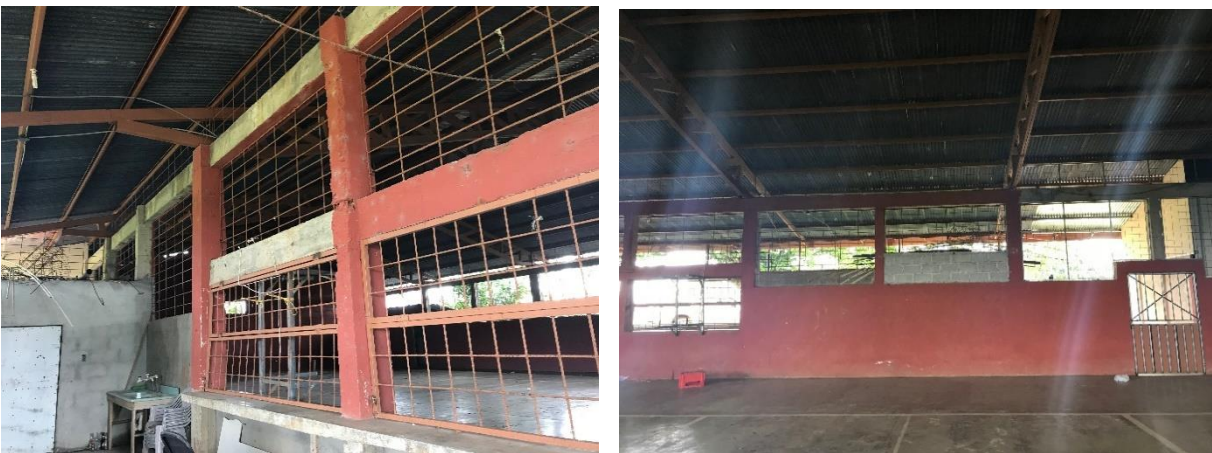
Imagen 4. Estado actual del salón comunal de San Antonio de Dos Aguas.
